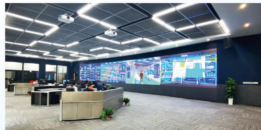
数据中心（指挥调度中心和数据机房）
